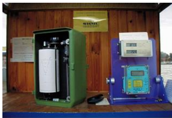
Meracie prístrojové vybavenie stanice
