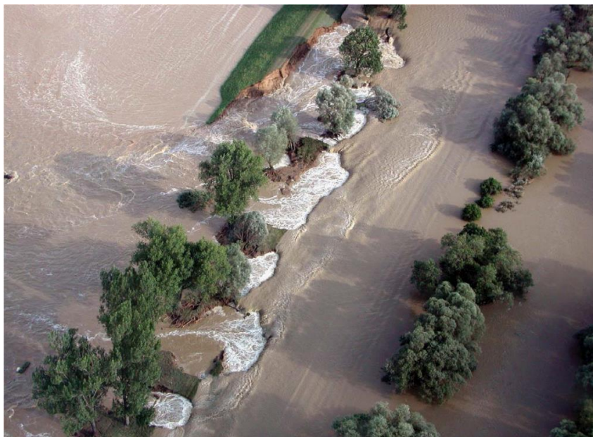
Obrázok 2: Vylievanie vody po deštrukcii hrádze (foto SVP).
