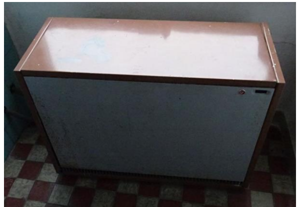
Obrázok 5 – Elektrické akumulčné kachle zázemie
