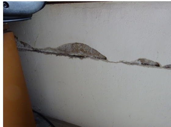
Obrázok 4 - Budova meteorologickej stanice Jaslovské Bohunice – detail statickej poruchy
