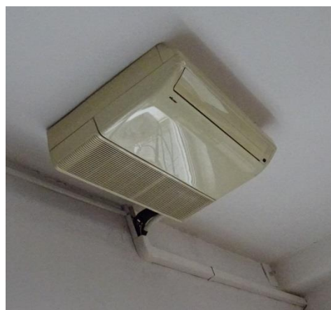
Obrázok 13 – Podstropná jednotka v observatóriu
