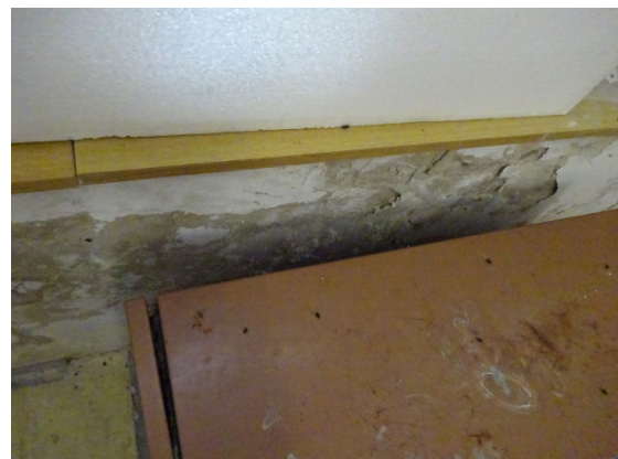
Obrázok 6 - Budova meteorologickej stanice Jaslovské Bohunice – detail vonkajšej steny miestnosť 224
