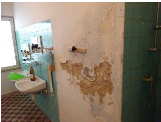
Obrázok 5 – Budova meteorologickej stanice Jaslovské Bohunice – detail steny vo WC prízemie
