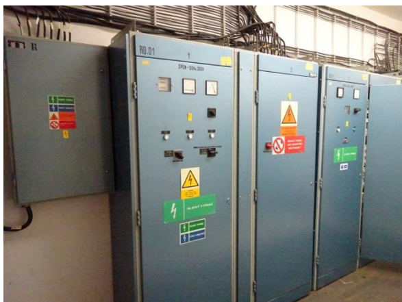
Obrázok 18 – Hlavný rozvádzač trafostanica
