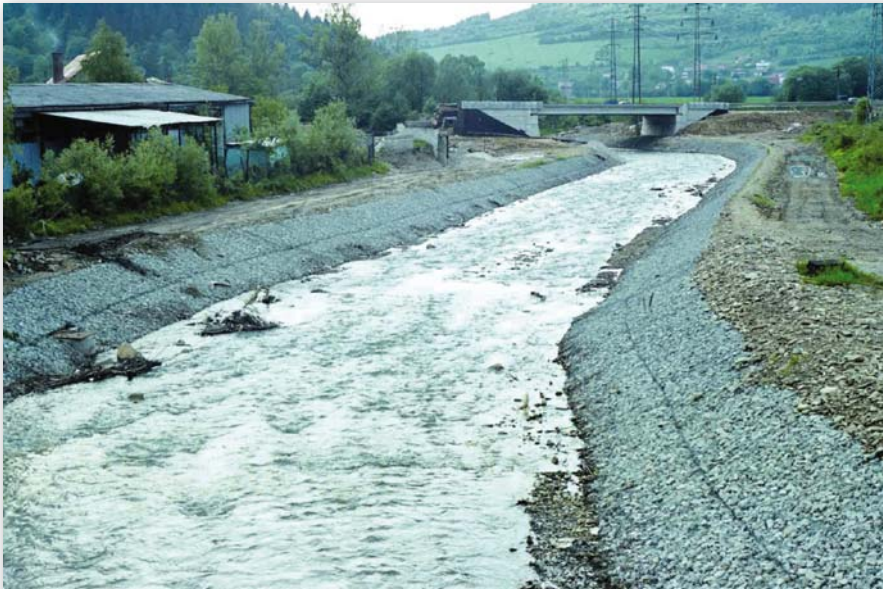
Obr. 3 Upravený úsek toku Oščadnica, svahy sú stabilizované drôtokamennými matracmi. Fig. 3 Regulated reach of the Oščadnica Brook, bank slopes are stabilized by the wire-cage mattresses.
